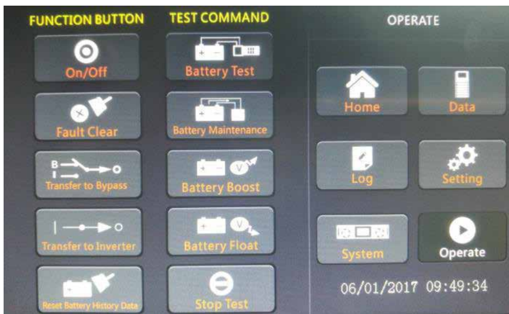
Рисунок 5.3 Тестирование батарейного массива Battery maintenance
