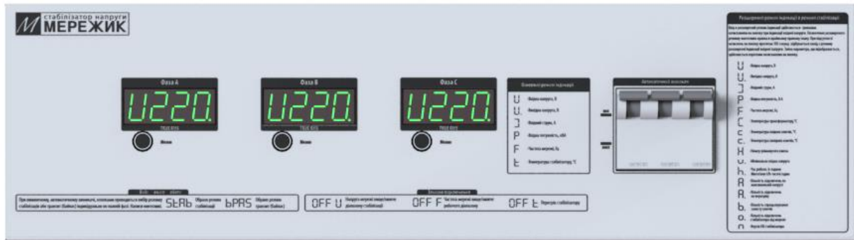
Рисунок 2. Зовнішній вигляд панелі керування
